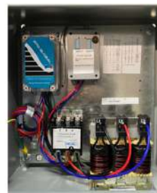
50kA (Protección de Motor)
